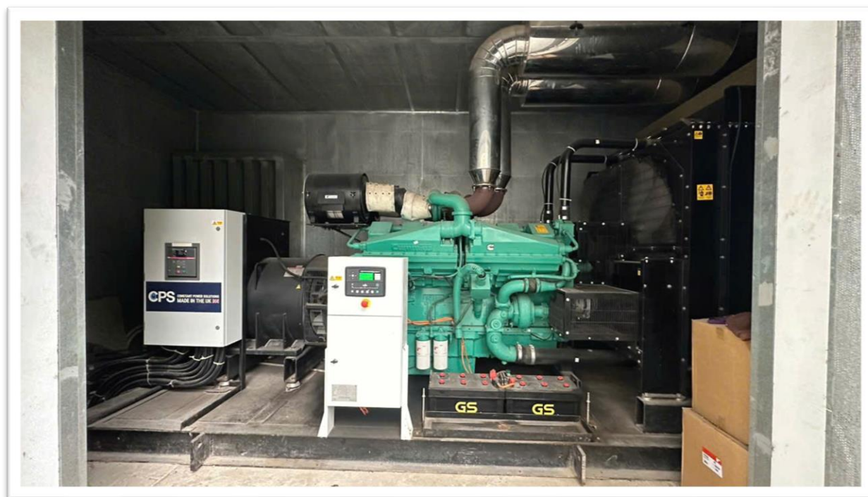
Hình 8. Máy phát điện dự phòng của cơ sở
